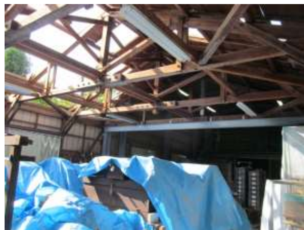
浸水した文化財保管庫（松伏町）
