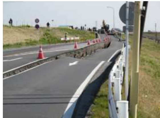
県道の地割れ (幸手市 平成 23 年)
