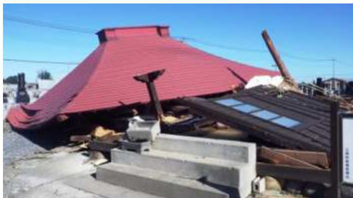
倒壊した浄安寺の地藏堂（熊谷市）
